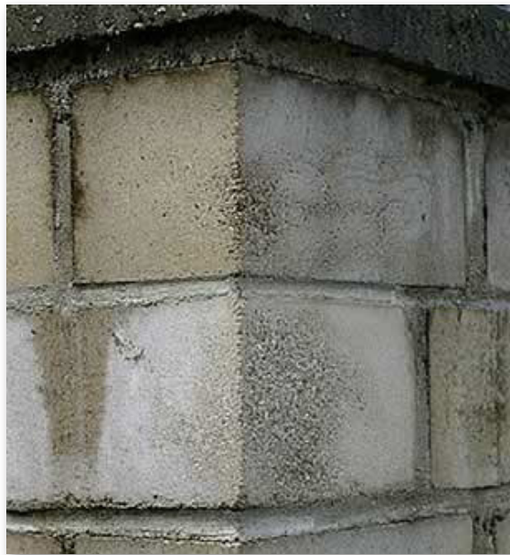
unversiegelte nicht gereinigte Oberfläche
